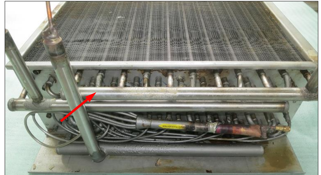
Bild 1: Übersichtaufnahme des bemängelten Sammlerrohres (Pfeil) mit mehrfachen Leckagestellen
