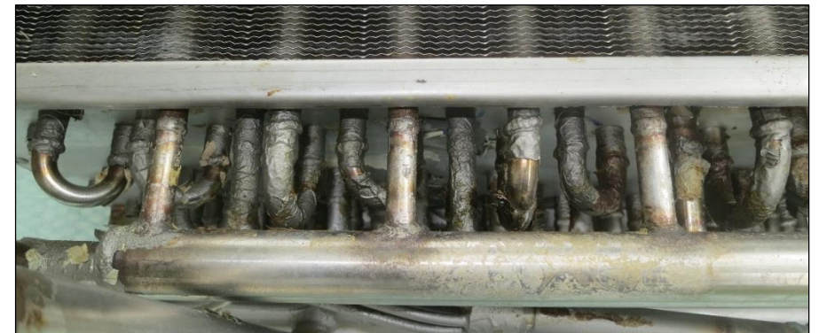
Bild 3: Detailaufnahme des Schadenbereichs
